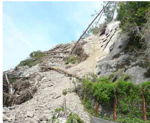
断続的な落石や小崩落が発生する斜面の状況
